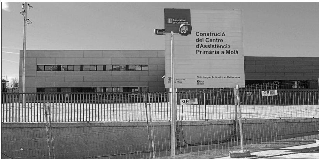
El nou centre d'assistència primària de Moià, sota el qual hi ha el polèmic pàrquing, quan estava en construcció
